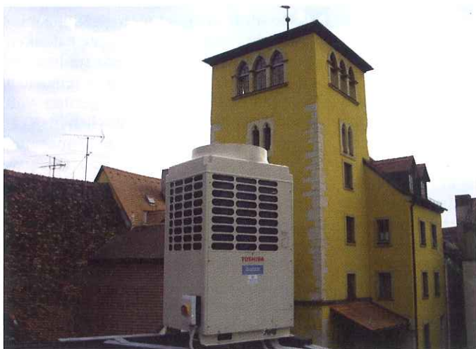
Für das Außengerät fand sich ein Platz auf der Dachlandschaft des Hinterhofs.
